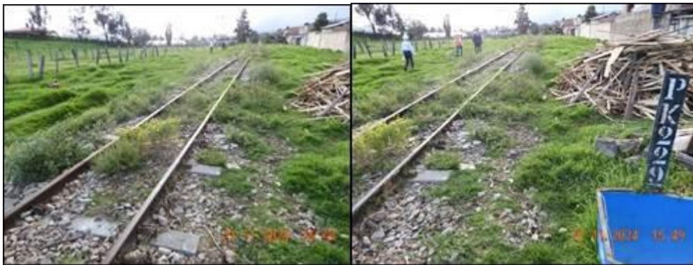
Figura 2. Estado PK229+750. Basalto contaminado con vegetación.
